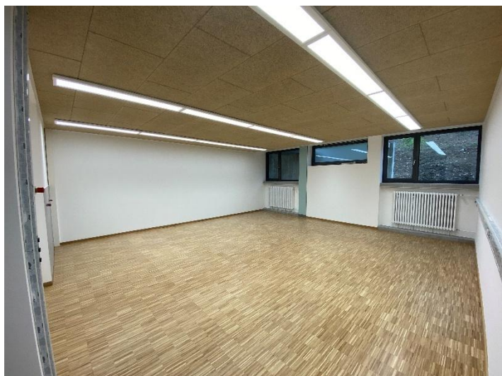
Abbildung 28: Akustikelemente in Klassenzimmern © Stadt Würzburg, FB Schule
